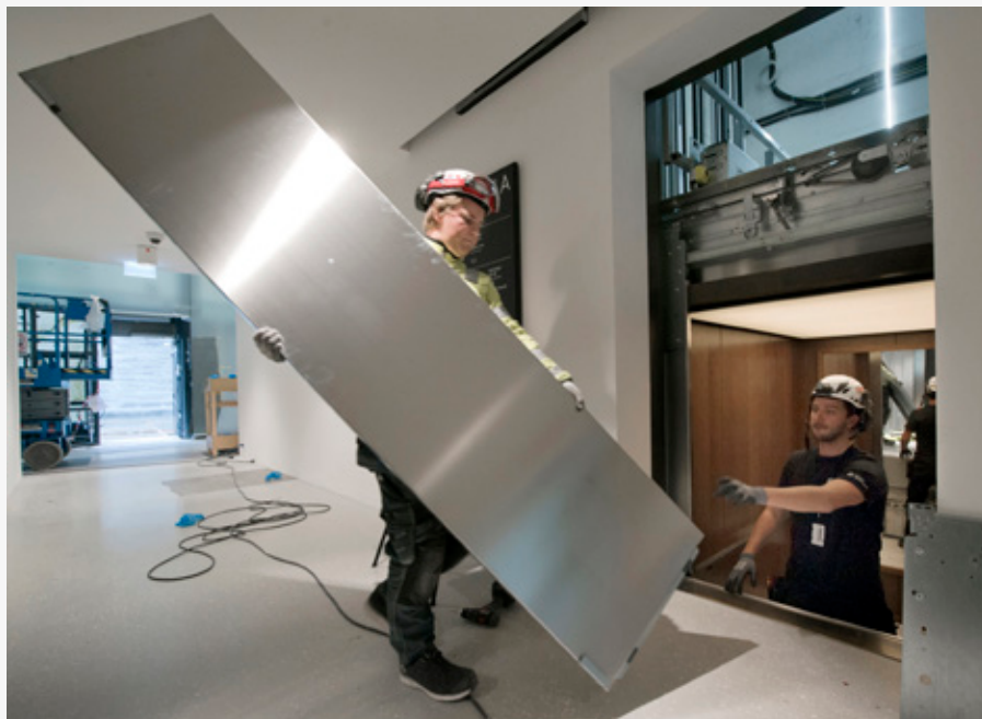
Otisklubben opplever for tiden litt mindre tilgang til arbeidet. Her er de i sving med heismontasjen på det nye Nasjonalmuseet som stod ferdig i 2022.
